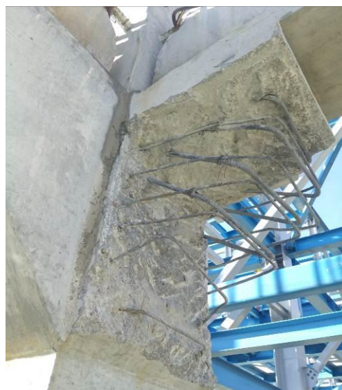
Рис. 3. Фото одной из обследуемых консолей колонн после частичного демонтажа бетона консоли
