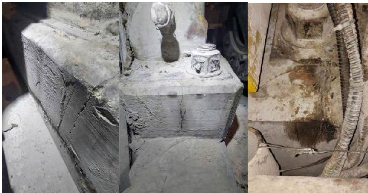
Рис. 4. Фото дефектов обследуемого фундамента
